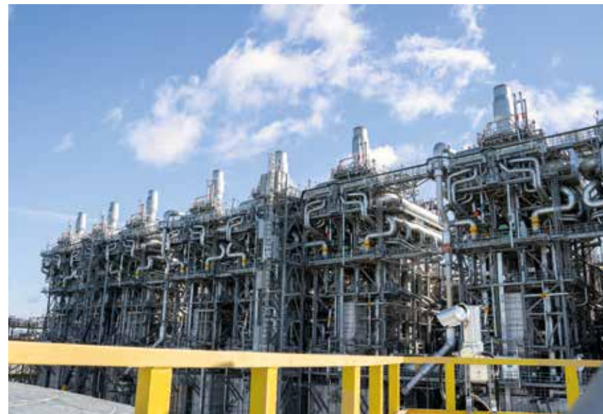
Рисунок 45. Печи пиролиза. Общий вид с лицевой стороны
