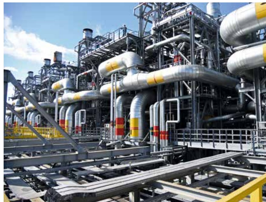
Рисунок 47. Трубопроводная обвязка печей пиролиза
