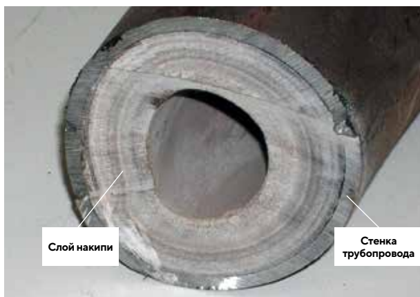
Рисунок 71. Слой накипи на внутренней поверхности трубопровода. Заметно, насколько сильно уменьшилось сечение трубы
