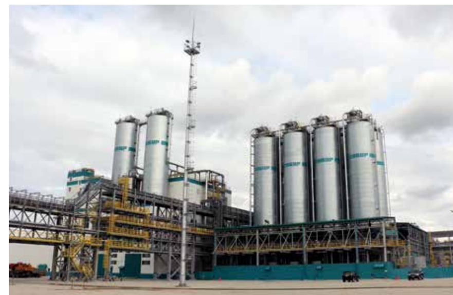
Рисунок 69. 8 гомогенизаторов установки гранулирования полипропилена смонтированы в 2 ряда
