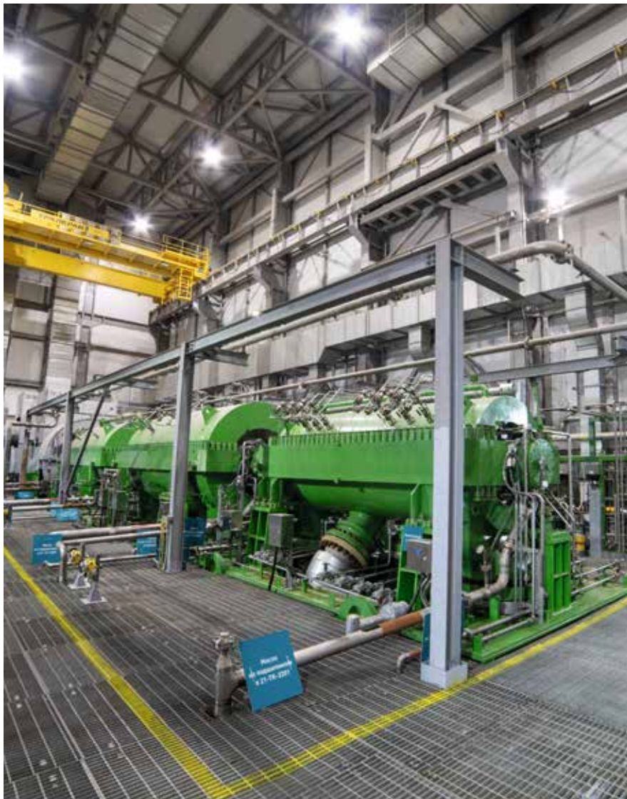
Рисунок 50. Один из турбоагрегатов цеха компримирования – компрессор пирогаза
